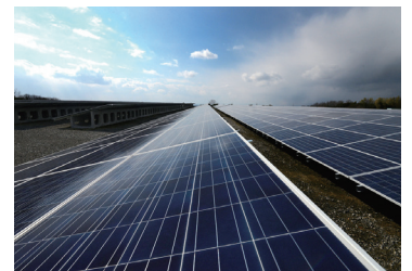
太陽光発電施設
